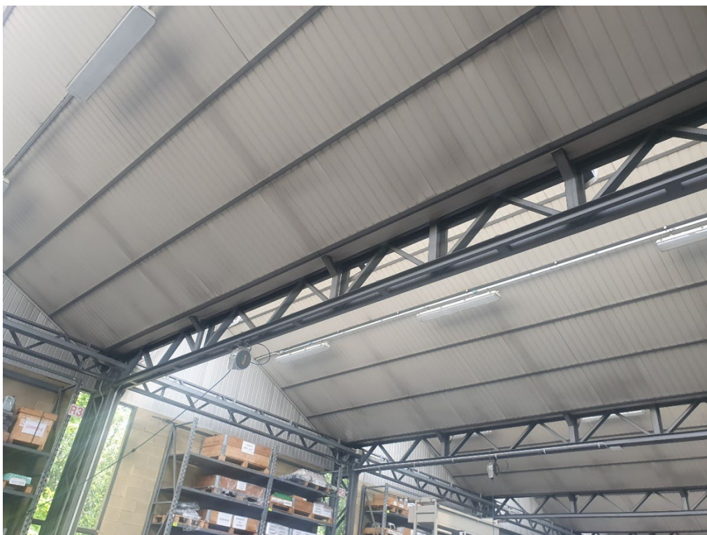
Figura 2.5 – Vista della struttura portante in carpenteria metallica e della copertura a shed
