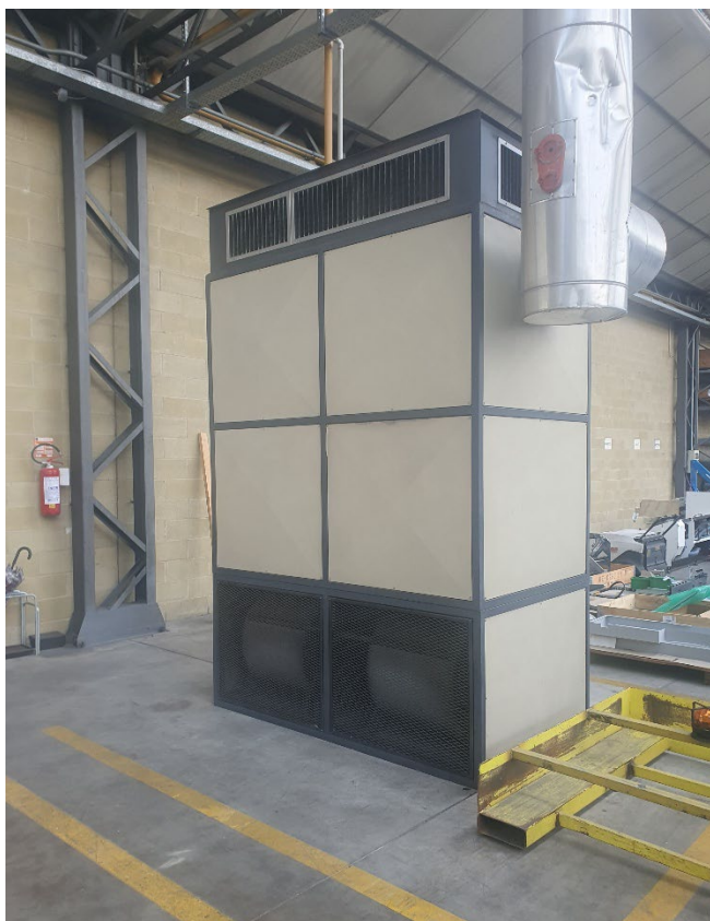
Figura 2.7 – Vista di uno dei generatori di calore a gas nello spazio produttivo
