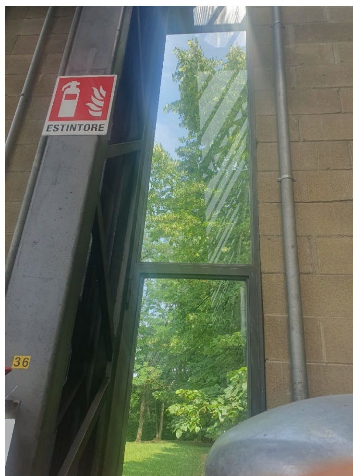
Figura 2.6 – Vista di un serramento dotato di vetro singolo, presente in una parete della zona produttiva
