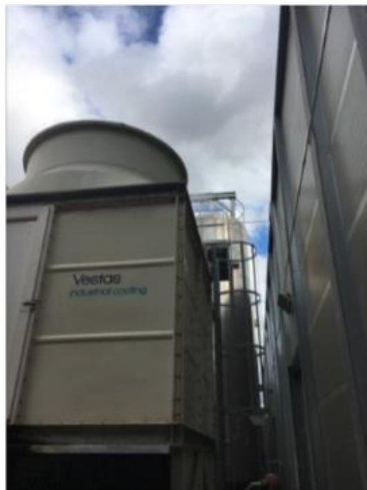
Figura 33: Struttura da mettere in sicurezza
