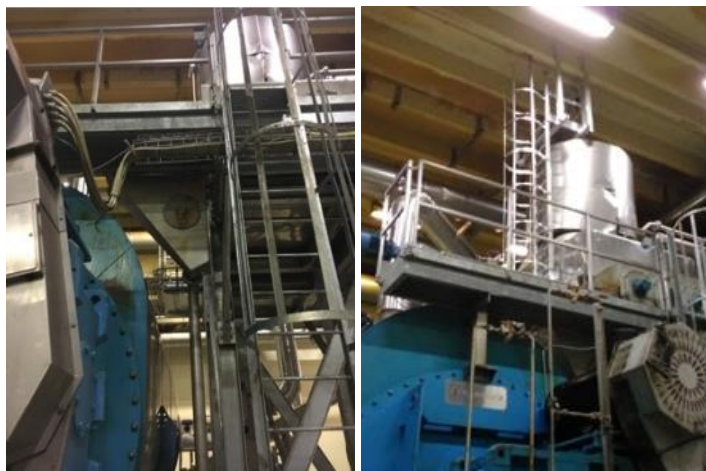
Figura 21 e 22: Messa in sicurezza dei macchinari con parapetti e scale a gabbia
