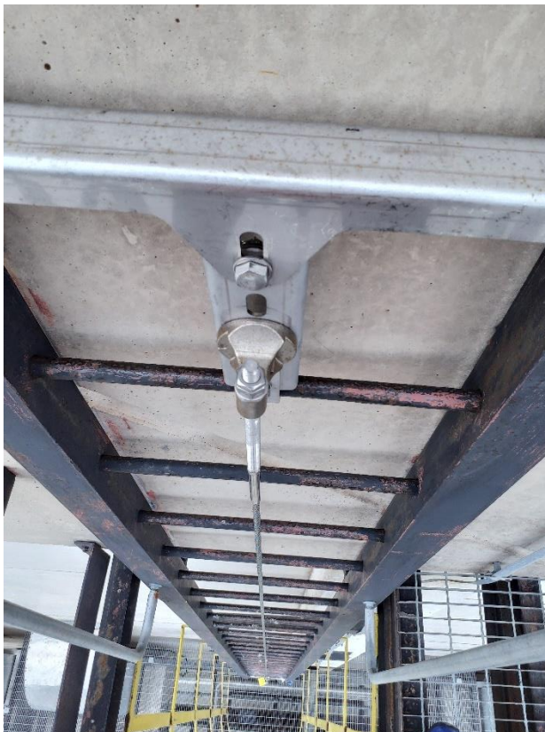
Figura 6: Vista dall'alto di una scala fissa e di un dispositivo di ancoraggio EN 353-1:2014+A1:2017 con cavo metallico installato centralmente sulla scala
