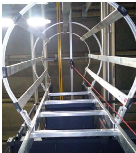
Figura 8: Scala fissa a gabbia con dispositivo anticaduta retrattile posizionato su dispositivo di ancoraggio opportunamente dimensionato. È visibile in figura, sulla destra, il cavo spia per richiamare il gancio del retrattile da collegare all’imbracatura per essere protetti in fase di salita e di discesa.
