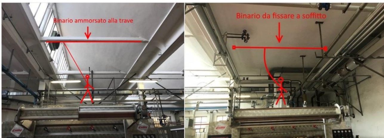
Figura 19a e 19b: Progetto di messa in sicurezza tramite l'installazione di dispositivi di ancoraggio di tipo D (binari) al di sopra di macchine tessili per poter accedere ed eseguire le attività di manutenzione in sicurezza
