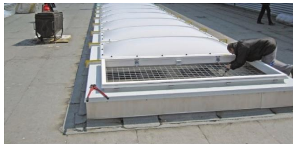
Figura 15b: La griglia fissa, installata sotto ai lucernari, impedisce che in caso di caduta la persona coinvolta cada nel vuoto
