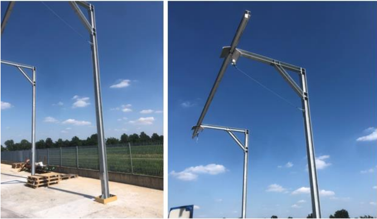
Figura 39: Baia di carico con installazione a suolo e dispositivo di ancoraggio EN 795:2012 tipo D e dispositivo anticaduta retrattile EN 360:2023*
