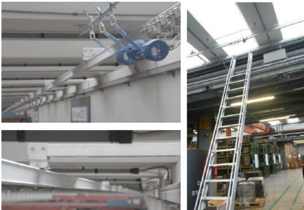
Figura 26: Dispositivi di ancoraggio tipo D con rastrelliera che ospita quattro retrattili collegati a una navetta di scorrimento sul binario. Scale per accedere alle vie di corsa.
