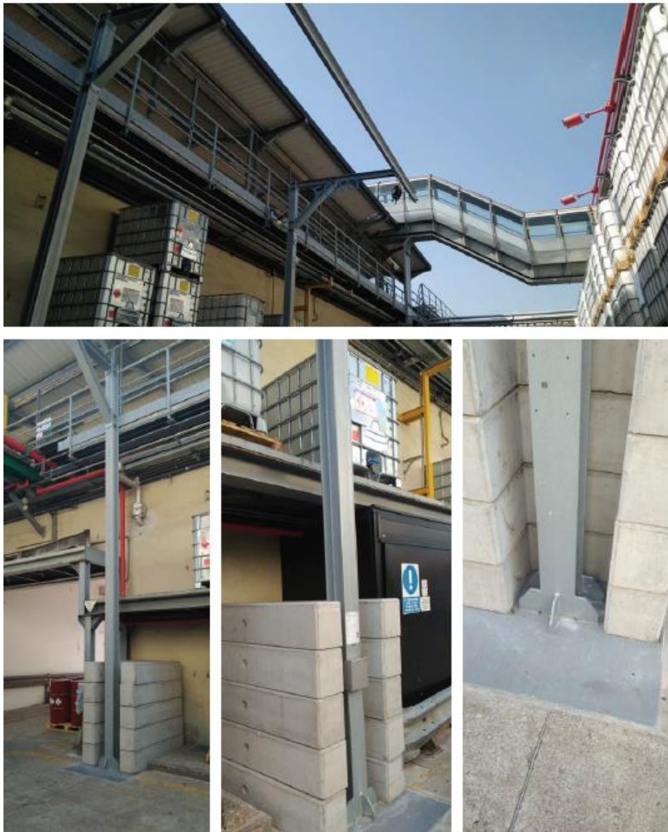
Figura 38: Baia di carico autoportante con contrappesi in calcestruzzo
