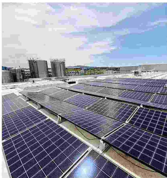
Un impianto fotovoltaico su un capannone
